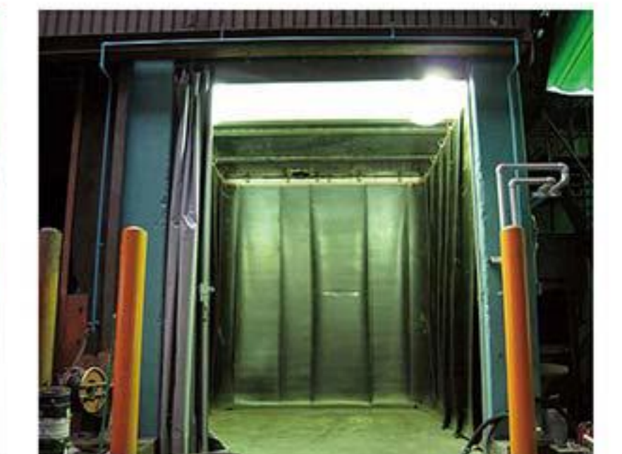
プラスト試験設備(東浜工場)
